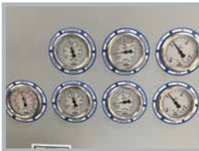
manómetros de aceite y refrigerante
